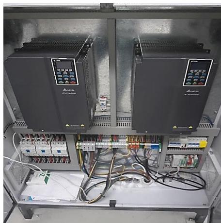
Εικόνα 41: Πίνακας ισχύος και ελέγχου δίδymου συστήματος αντλιών
