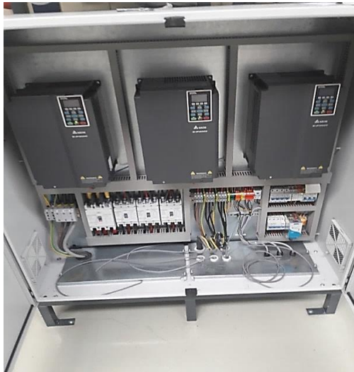
Εικόνα 39: Πίνακας ισχύος τρίδymου συστήματος αντλιών
