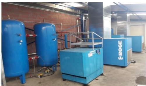
Εικόνα 42: Κεντρικό σύστημα παραγωγής πεπιεσμένου αέρα
