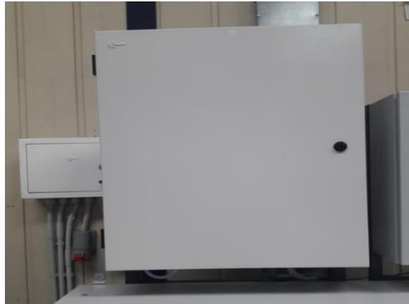
Εικόνα 53: Θέση πίνακα ελέγχου του συστήματος SCADA
