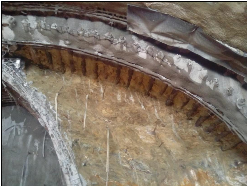
Εικόνα 25 : Μέτωπο εκσκαφής με συνδυασμό υποστήριξης από αγκύρια μετώπου fiberglass και δοκούς προπορείας (Πηγή: Γεωργίου Δ.).
