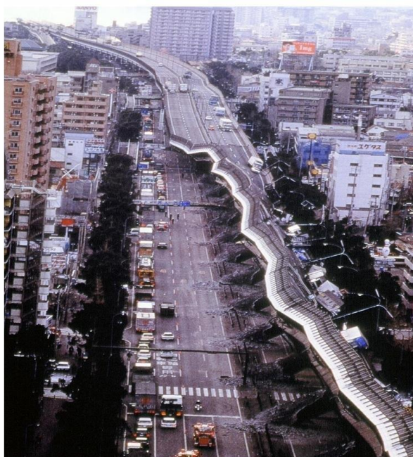
Εικόνα 1.1 Κατάρρευση του υπερυψωμένου αυτοκινητόδρομου Hanshin, Kobe 1995 (Πηγή: Philip Esper, Clarke Bond et al. 1996)
