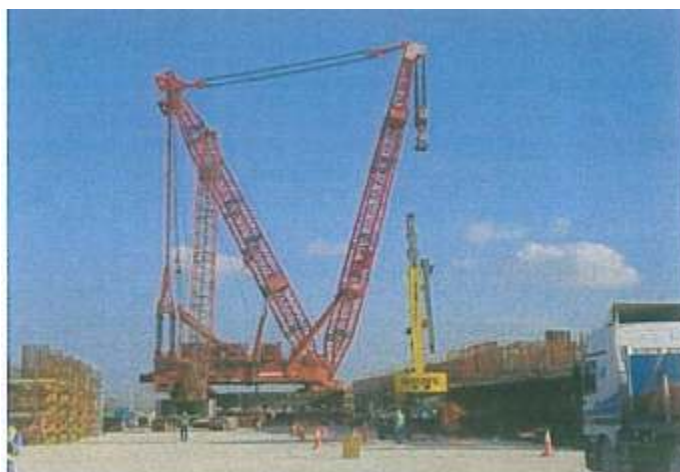
Σχήμα 6.6: Γερανός ανύψωσης μεγάλων φορτίων (κόκκινος) και βοηθητικός γερανός για την κατακόρυφη ευθυγράμμιση του φορτίου (κίτρινος)
