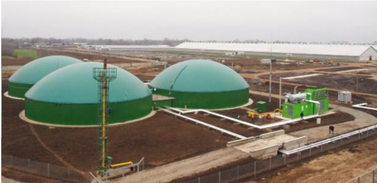
Εικόνα 1.3: Μονάδα βιοαερίου της εταιρείας «Επίλεκτος» στα Φάρσαλα Λάρισας
