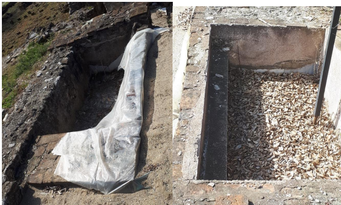
Εικόνα 36. Φωτογραφίες των ατομικών δεξαμενών κρύου νερού στη νότια και βόρεια πλευρά. Πηγή: της ίδιας από προσωπικό αρχείο. Έτος 2019.
