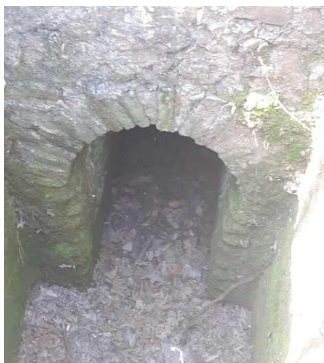
Εικόνα 27. Φωτογραφία του κεντρικού αγωγού αποχέτευσης του συγκροτήματος των Μεγάλων Θερμών. Πηγή: της ίδιας από προσωπικό αρχείο. Έτος 2019.
