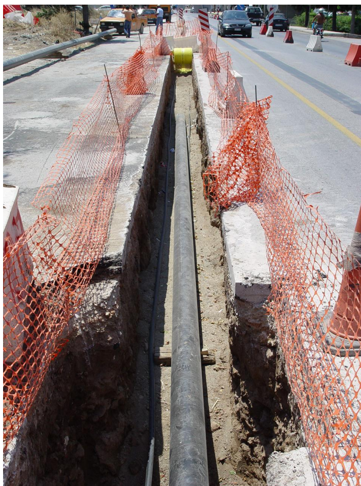
Εικόνα 6 – 3. Εγκατάσταση Αγωγού Φυσικού Αερίου Μέσης Πίεσης στην πόλη της Χαλκίδας (περιοχή Καστέλλα)
