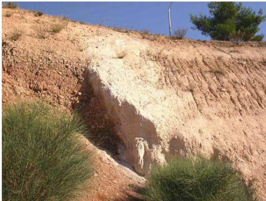
Εικόνα 6 - 7. Το ρήγμα P7 στη θέση του εργοστασίου ΕΒΙΟΠ
