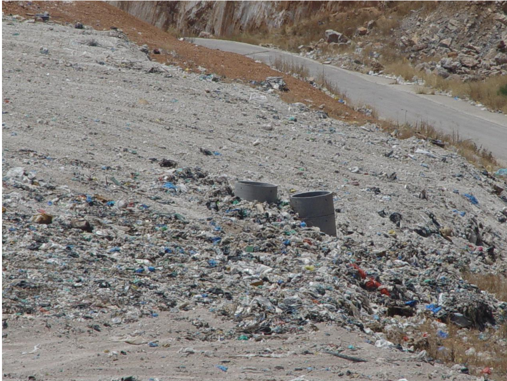
Εικόνα 7 - 7. Ειδικοί κατακόρυφοι διάτρητοι αγωγοί απαγωγής του βιοαερίου στο ΧΥΤΑ Χαλκίδας
