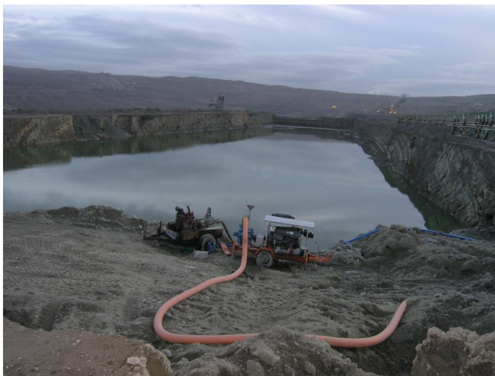
Εικόνα 2.4.1: Συλλογή των επιφανειακών και υπόγειων νερών και άντληση αυτών με εσωτερικό αντλιοστάσιο στο ορυχείο Αναργύρων, Αμόνταιο. Πηγή: Προσωπικό Αρχείο.
