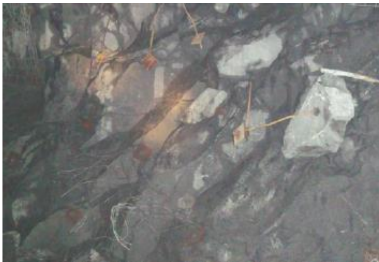
Εικόνα 19: Αστοχία μεταξύ πλέγματος και ηλώσεων (Cai, 2013)
