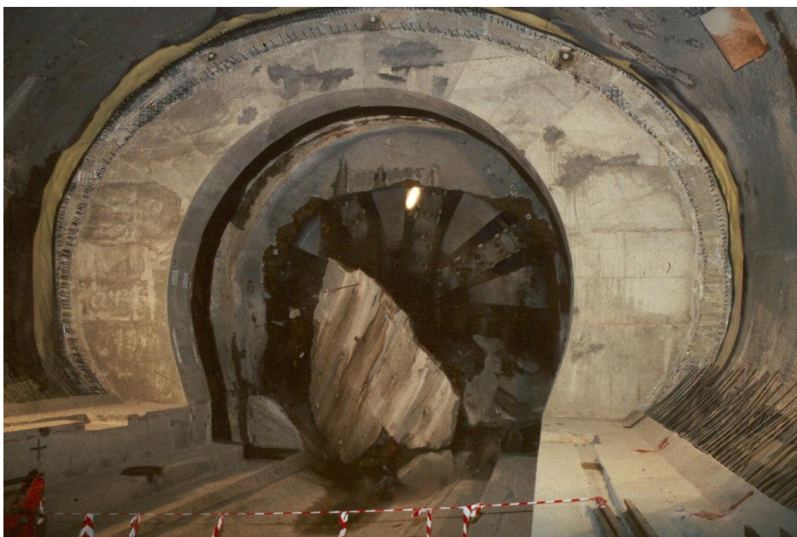
Εικόνα 4-4, Είσοδος του TBM σε σταθμό κατασκευασμένο με υπόγεια διάνοιξη, Πηγή: Αττικό Μετρο
