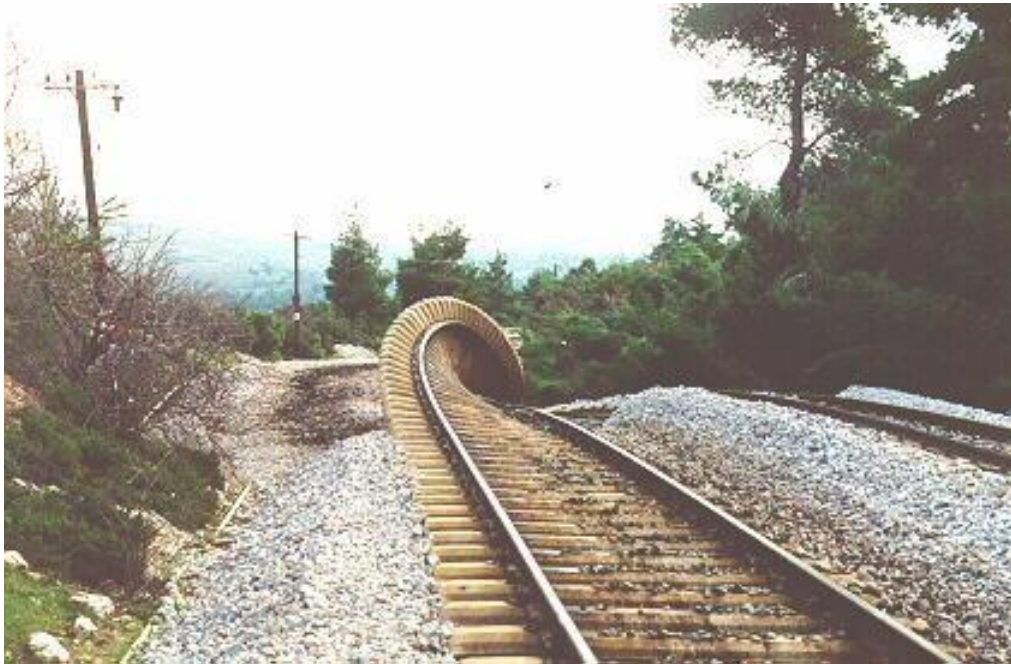
Εικόνα 7: Κατολίσθηση Μαλακάσας (άποψη σιδηροδρομικής γραμμής Αθηνών – Θεσσαλονίκης), 1995
