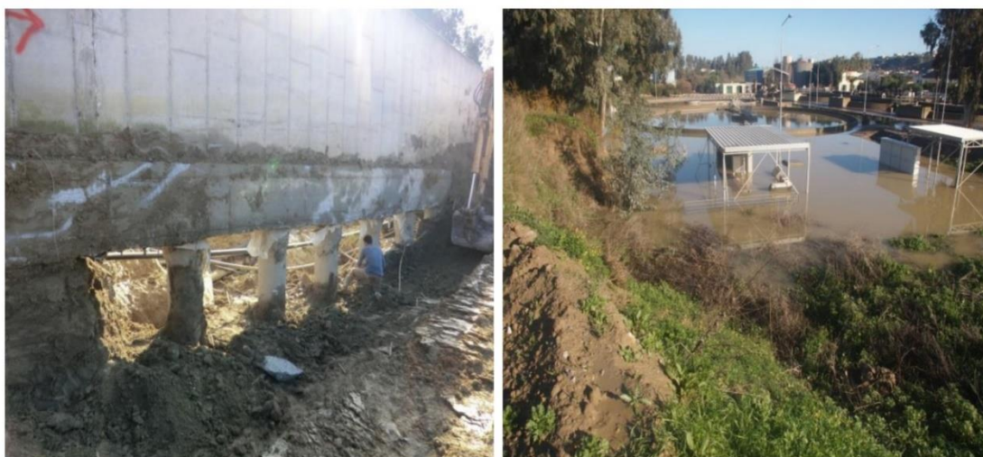
Σχήμα 2.17: Υποσκαφή πασσαλότοιχου (αριστερά) και πλημμύρα εγκαταστάσεων ΒΙΟΚΑ Ηρακλείου (δεξιά) ως αποτέλεσμα της πλημμύρας στις 13/01/2015 (Πηγή: Σχέδιο Διαχείρισης Κινδύνων Πλημμύρας των Λεκανών Απορροής Ποταμών του Υδατικού Διαμερίσματος Κρήτης, 2018)
