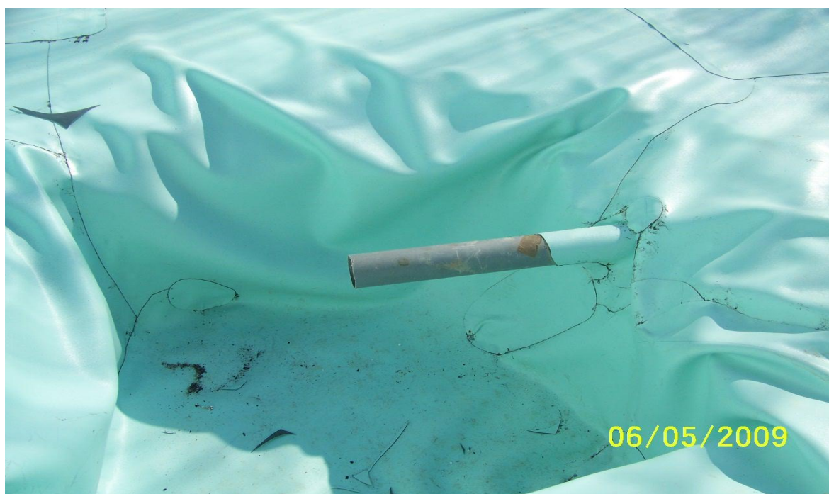
Εικόνα 4.62. Διακοπή της μεμβράνης από σωλήνα
