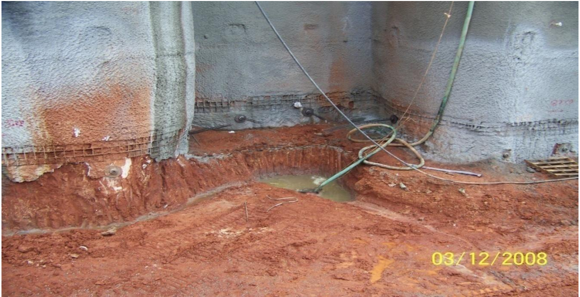
Εικόνα 4.13. Φρέαρ αποστράγγισης υδάτων.
