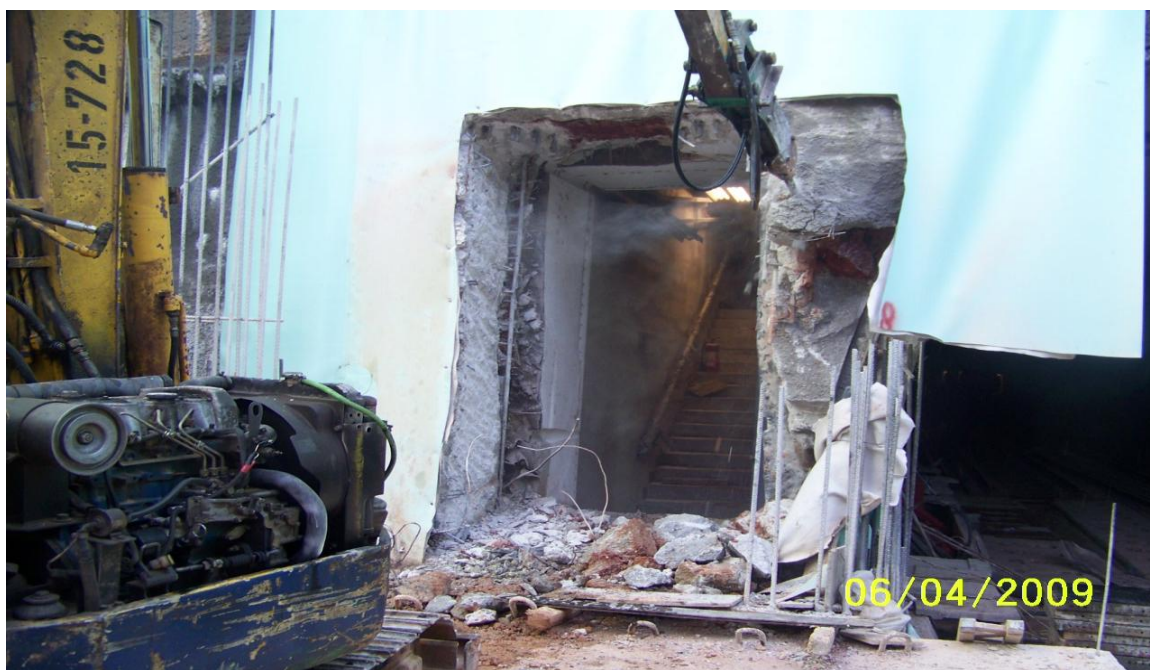
Εικόνα 5.18. Καθαίρεση σκυροδέματος στο άνοιγμα για τη σύνδεση με το υπάρχον φρέαρ στη δυτική πλευρά.
