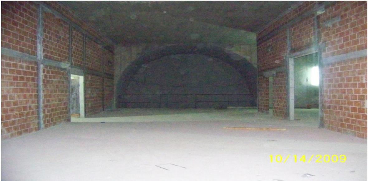
Εικόνα 5.24. Τεχνικός χώρος-φρέαρ αποτώνωσης αέρα
