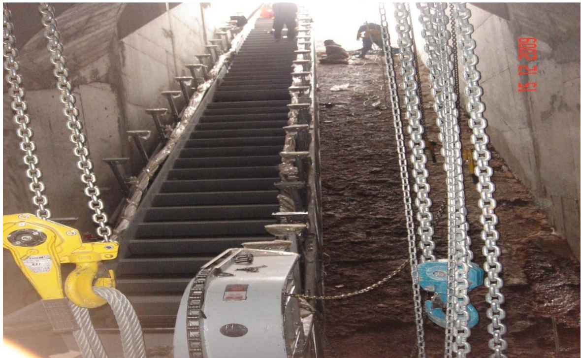
Εικόνα 5.19. Κυλιόμενες κλίμακες στη Νότια είσοδο.
