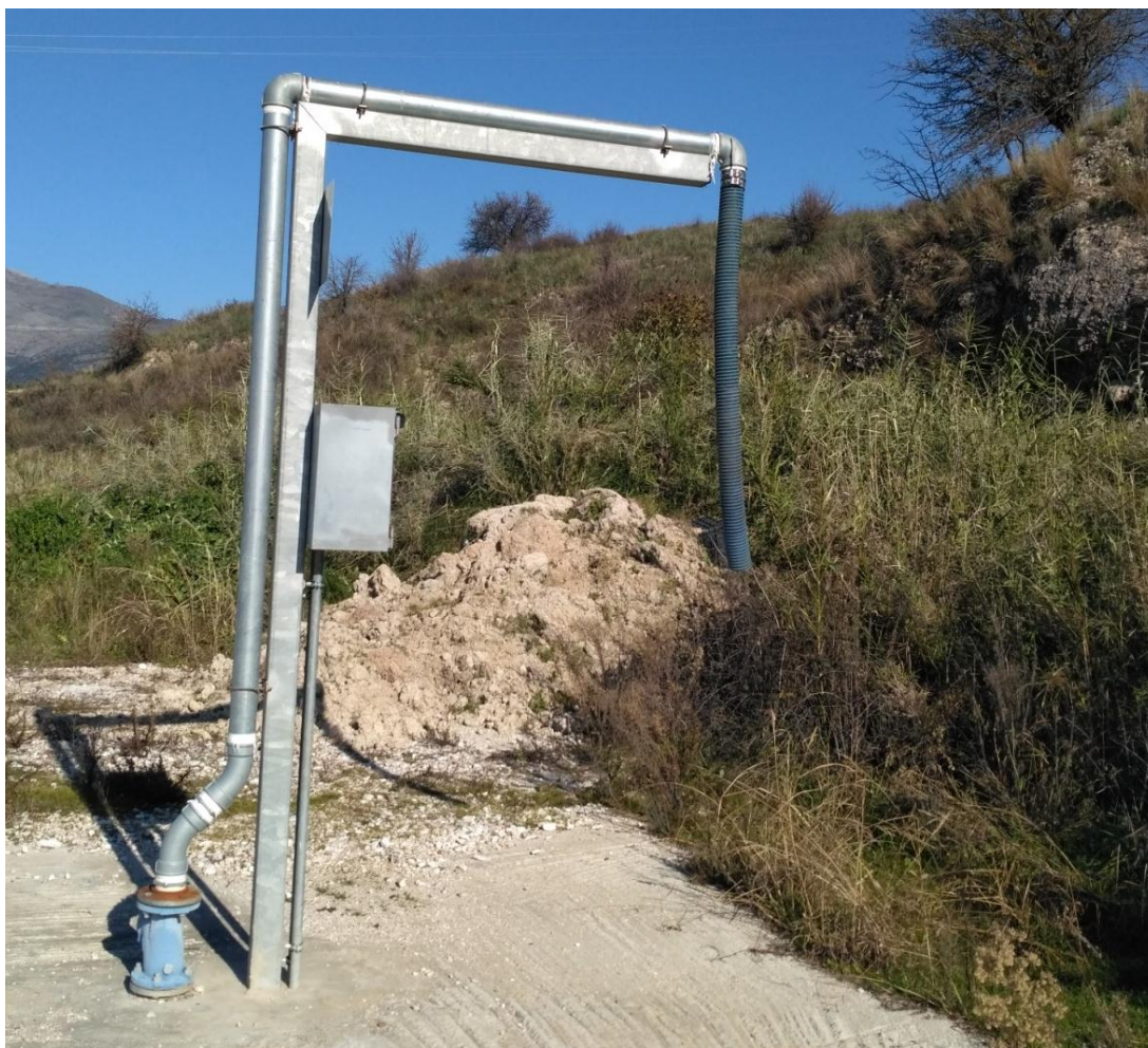
Εικόνα 18: Υποδομή υδροληψίας για την πλήρωση των βυτίων ψεκασμού.
