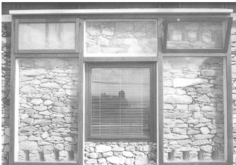
Εικόνα 6: Τοίχος Trombe κατασκευασμένος με ξύλινη κατασκευή που φέρει το διαφανές υλικό (τζάμι) και πέτρινη τοιχοποιία (θερμική μάζα).
