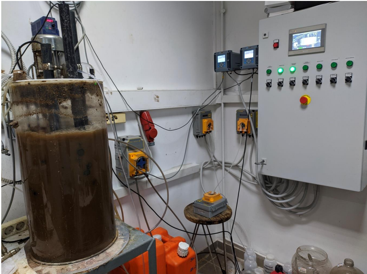
Εικόνα 7: Εργαστηριακό σύστημα επεξεργασίας στραγγιδίων IFAS-SBR
