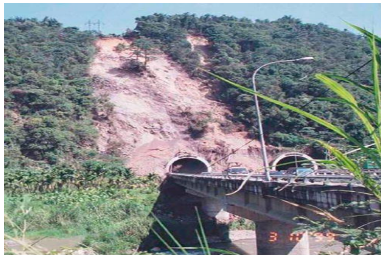
Σχήμα 2.12: Αστοχία πρανούς σε είσοδο σήραγγας, σεισμός Chi-Chi, Taiwan (Hashashetal., 2001)
