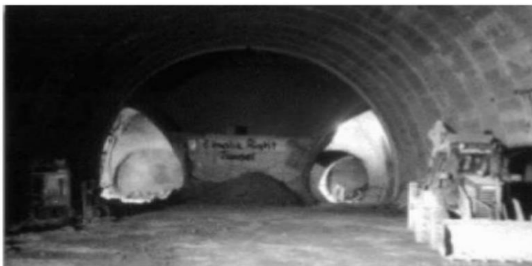
Σχήμα 2.14: Σήραγγα Volu, τμήμα που αποκαταστάθηκε μετά το σεισμό (Menkiti, 2001)
