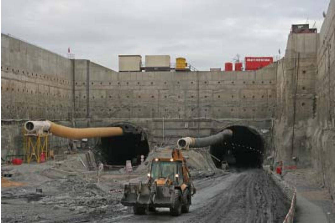
Εικόνα 2.27: Είσοδος σήραγγας και σύστημα εξαερισμού ΠΗΓΗ: ita-aites.cz
