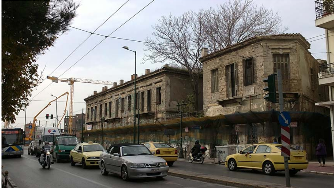
Εικόνα 3.11: Μισογκρεμισμένο κτίριο στον Κεραμεικό
