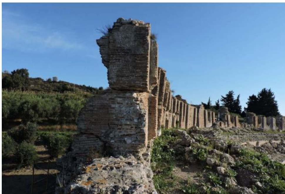
Εικόνα 3.22: Ο τοίχος της περιμετρικής στοάς του θεάτρου. Διακρίνονται μορφολογικά στοιχεία και παραμορφώσεις. Η κατασκευή διατηρεί σε μεγάλο ποσοστό το αρχικό της ύψος [34]
