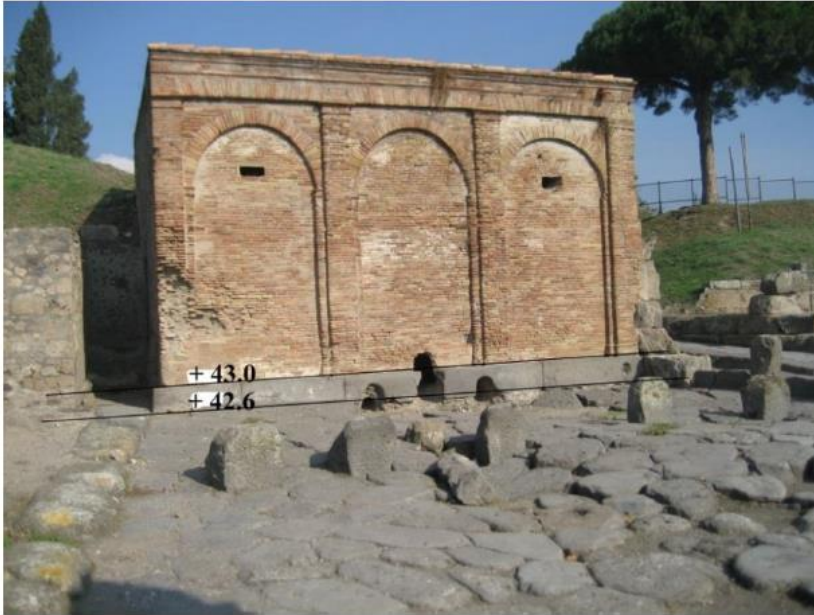
Εικόνα 2.17 Νότια πρόσοψη του Castellum Aquae, με τα τρία ανοίγματα για τους αγωγούς. Σημειωμένα πάνω στη φωτογραφία τα επίπεδα των ανοιγμάτων Πηγή: (Olsson, 2015, Figure 2.2, p.29).
