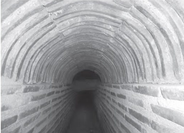
Εικόνα 3.2 Τμήμα της σήραγγας του Αδριάνειου, κάτω από το Ολυμπιακό Χωριό. Τα τοιχώματα είναι κατασκευασμένα με βάση την μέθοδο opus latericium. Πηγή: (Chiotis, 2018, Figure 3a, p.75).
