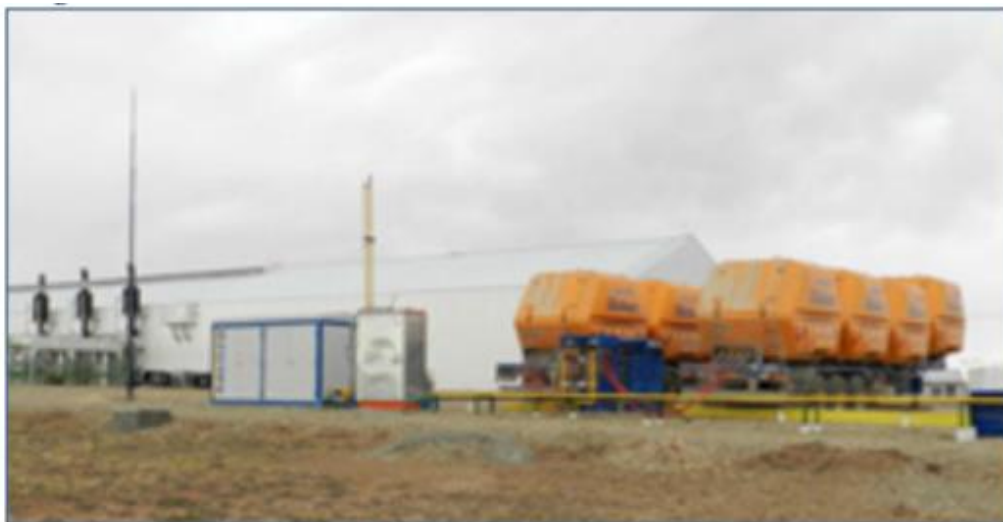
Εικόνα 17: Ράμπα τοποθέτησης φιαλών [159]
