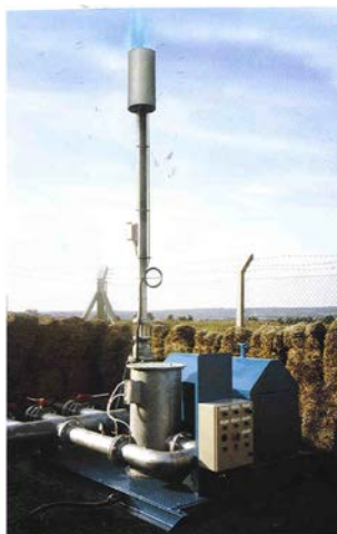
Εικόνα 6: πυρσός καύσης βιοαερίου
