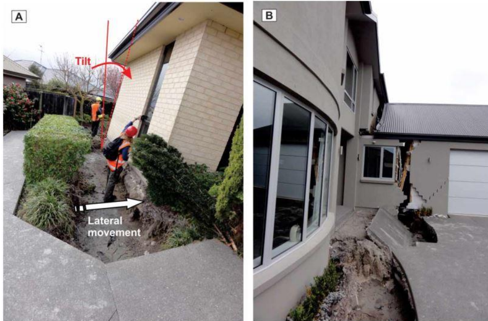
Σχήμα 2.8: Αστοχίες κατασκευής λόγω οριζόντιας εξάπλωσης στη Νότια πλευρά του ποταμού Κάιαιοι στον σεισμό του Σεπτεμβρίου 2010 (Cubrinovski et al, 2012).
