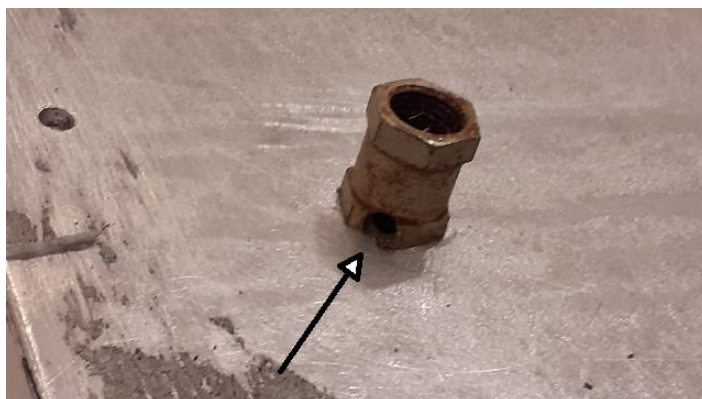
Εικόνα 4.5: Λεπτομέρεια από το πίσω μέρος του ακροφυσίου εξόδου του υγρού αζώτου. Η οπή κοντά στην πίσω επιφάνεια του ψυχόμενου δαπέδου εξασφαλίζει κατά το δυνατόν ότι το άζωτο εξέρχεται όταν πλέον έχει πλημμυρίσει το δοχείο.
