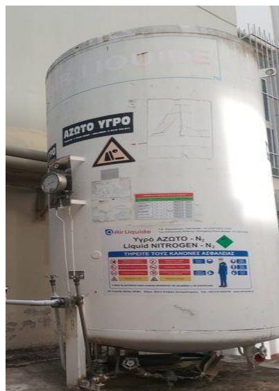
Εικόνα 3.10: Κυλινδρική δεξαμενή Dewar 1000 L για υγρό άζωτο στο ΕΠΤ-ΕΜΠ
