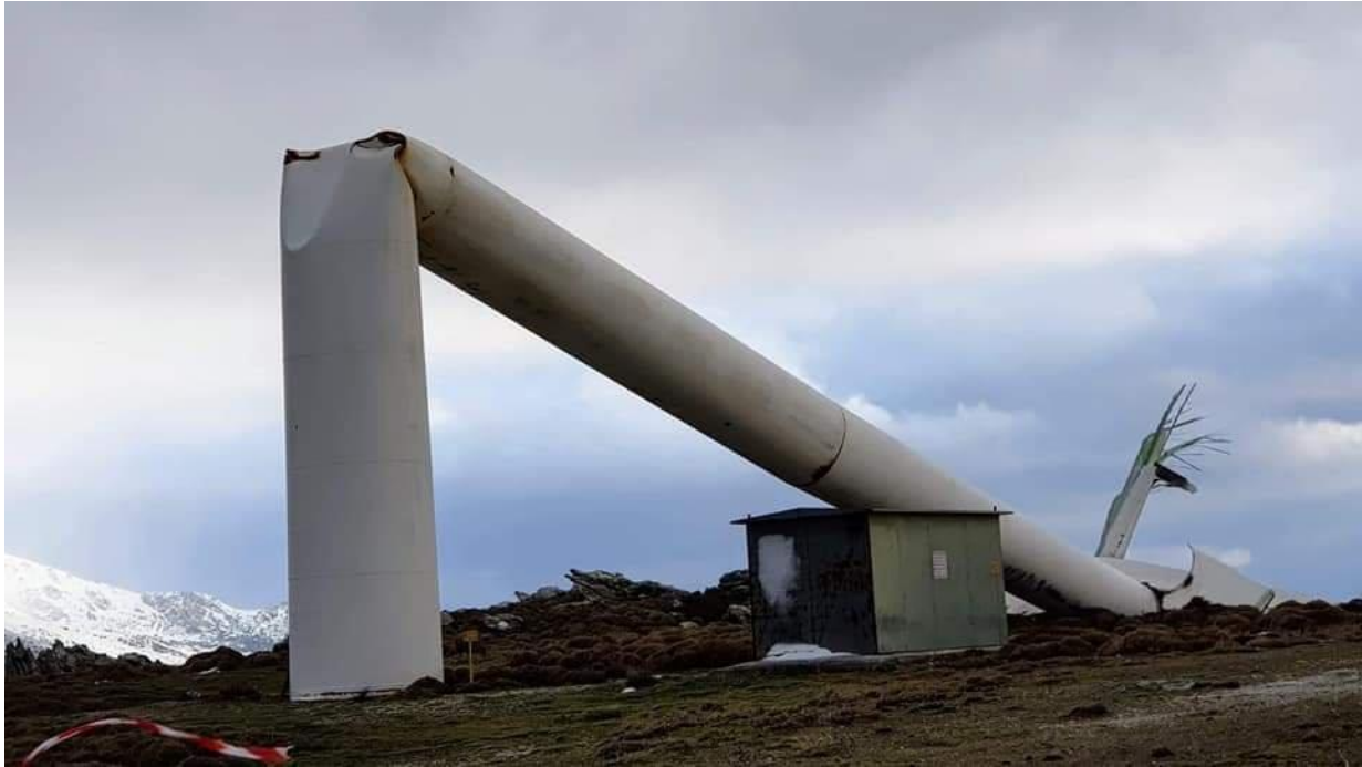
Εικόνα 1.17: Αστοχία πυλωνα ανεμογεννήτριας στην Εύβοια, κατά τα ακραία καιρικά φαινόμενα του «Ηφαιστίωνα», στις 09/01/2020
