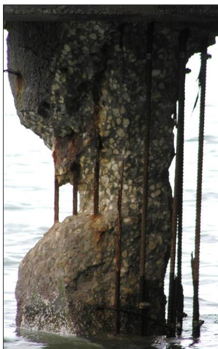
Σχήμα 5: Διάβρωση οπλισμού σκυροδέματος σε επαφή με θαλασσινό νερό (Πηγή: Vector Corrosion Services, 2017)
