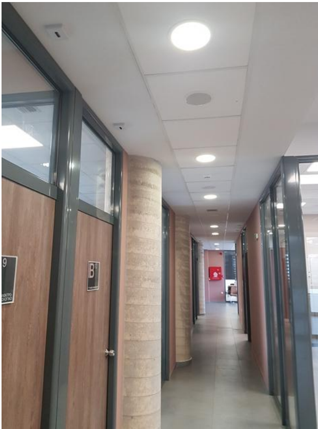
Εικόνα 12: Φωτισμός εσωτερικών χώρων (διάδρομοι)
