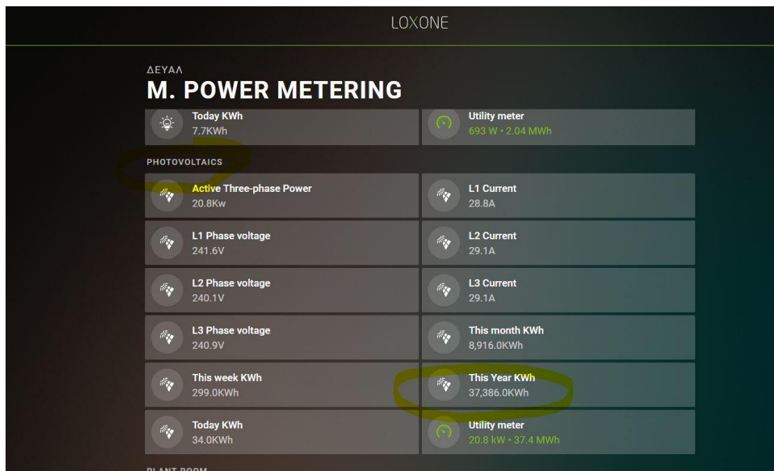
Εικόνα 34: Συνολική παραγωγή ηλεκτρικής ενέργειας από τα φωτοβολταϊκά 10μηνου 01/01/2017-31/10/2017
