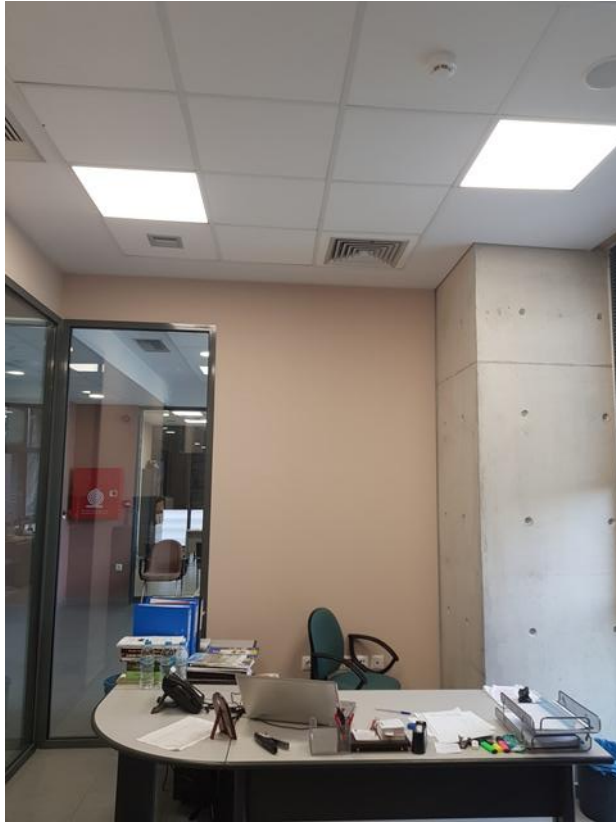
Εικόνα 13: Φωτισμός εσωτερικών χώρων (γραφεία)
