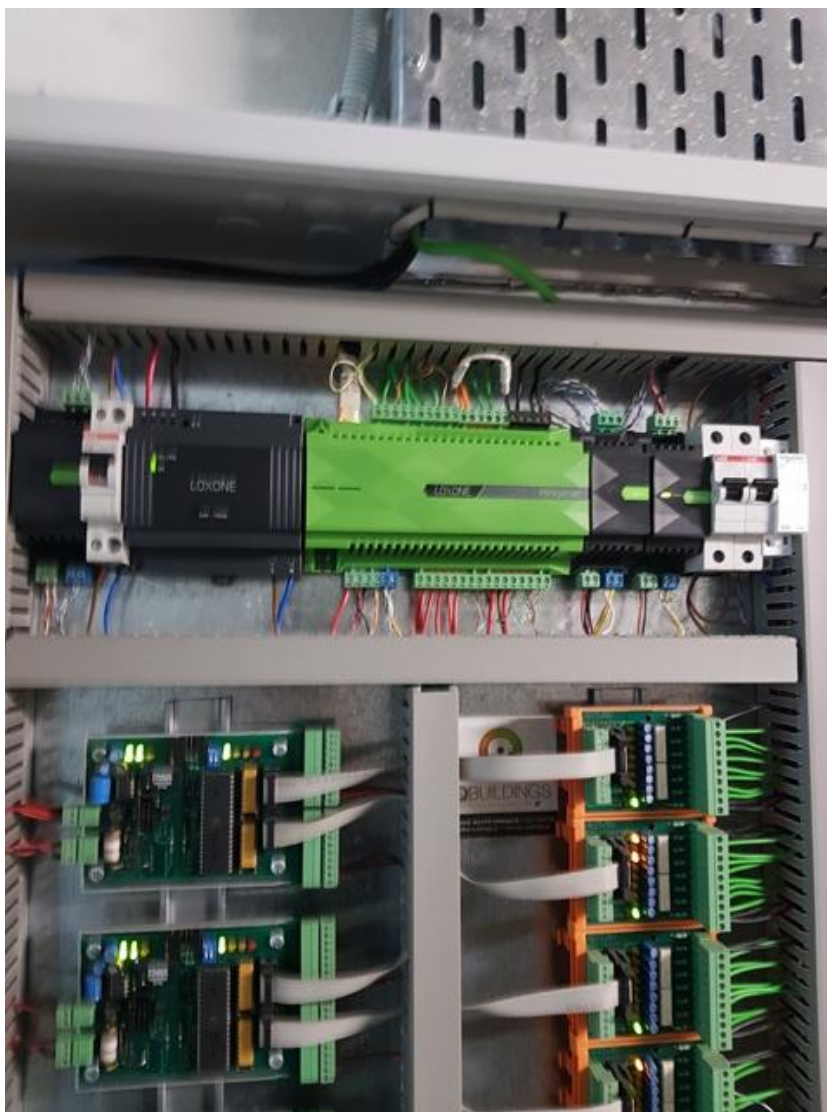
Εικόνα 18 : Κεντρική μονάδα (BMS)
