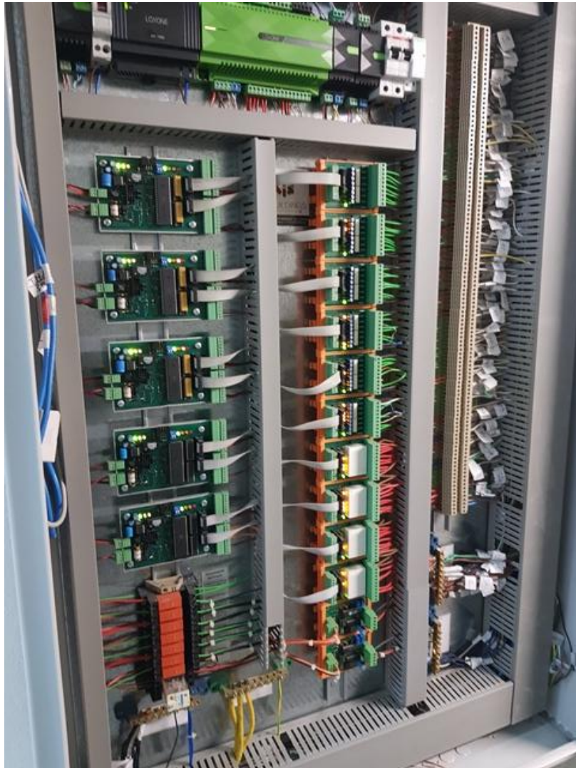
Εικόνα 17 : Κεντρική μονάδα (BMS)
