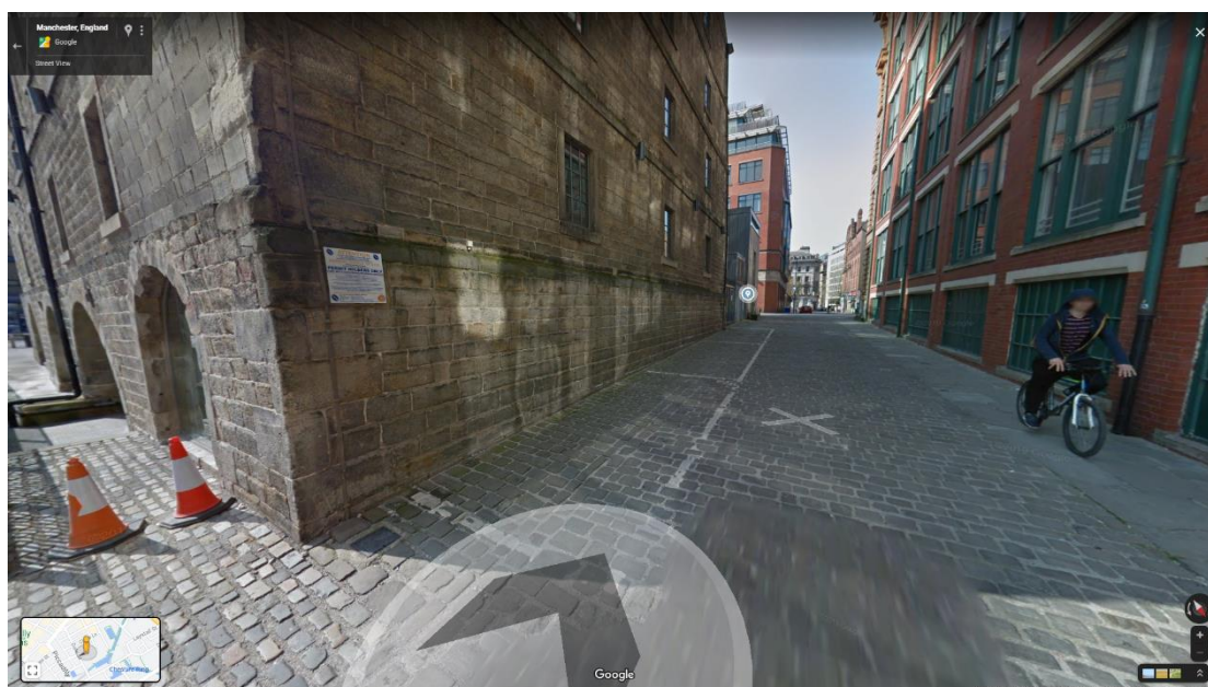
Εικόνα 3.23: Παράδειγμα τμήματος χωρίς κατασκευασμένο πεζοδρόμιο: S9=0 (Πηγή: Google Street View)
