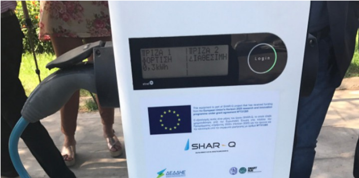
Σχήμα 2.10 Σταθμός φόρτισης ηλεκτρικού οχήματος
