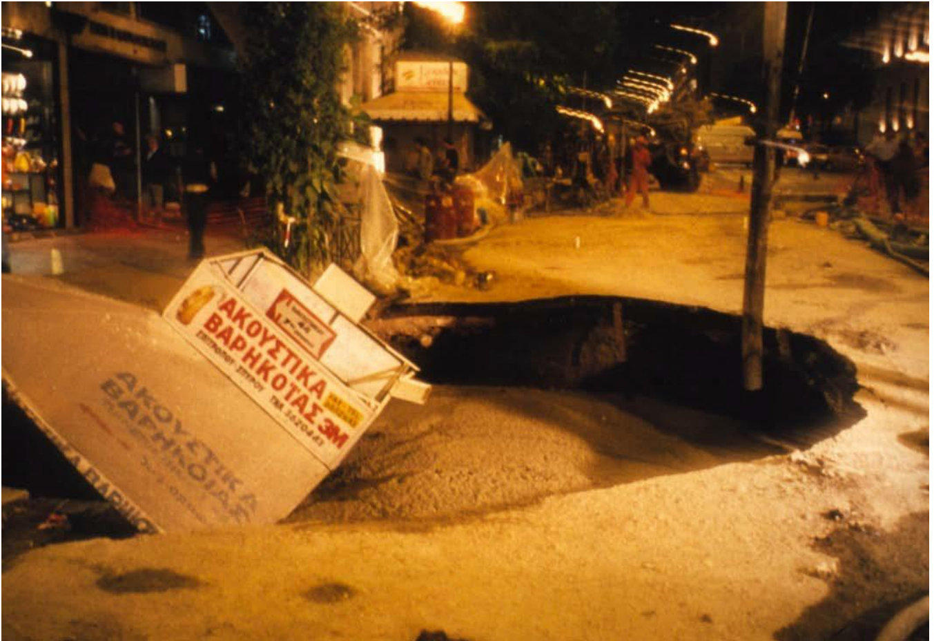
Σχήμα 8: Κατάρρευση οδοστρώματος επί της Οδού Πανεπιστημίου (Μαρίνος, 2008)
