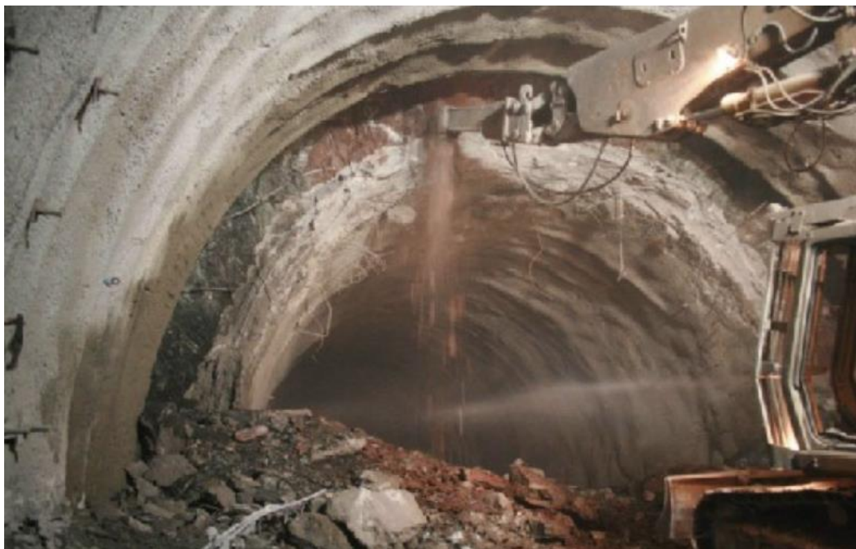
Σχήμα 5: Αστοχία προσωρινής υποστήριξης λόγω συγκλίσεων στο Νότιο Μέτωπο (ΕΡΓΟΣΕ Α.Ε., 2013)
