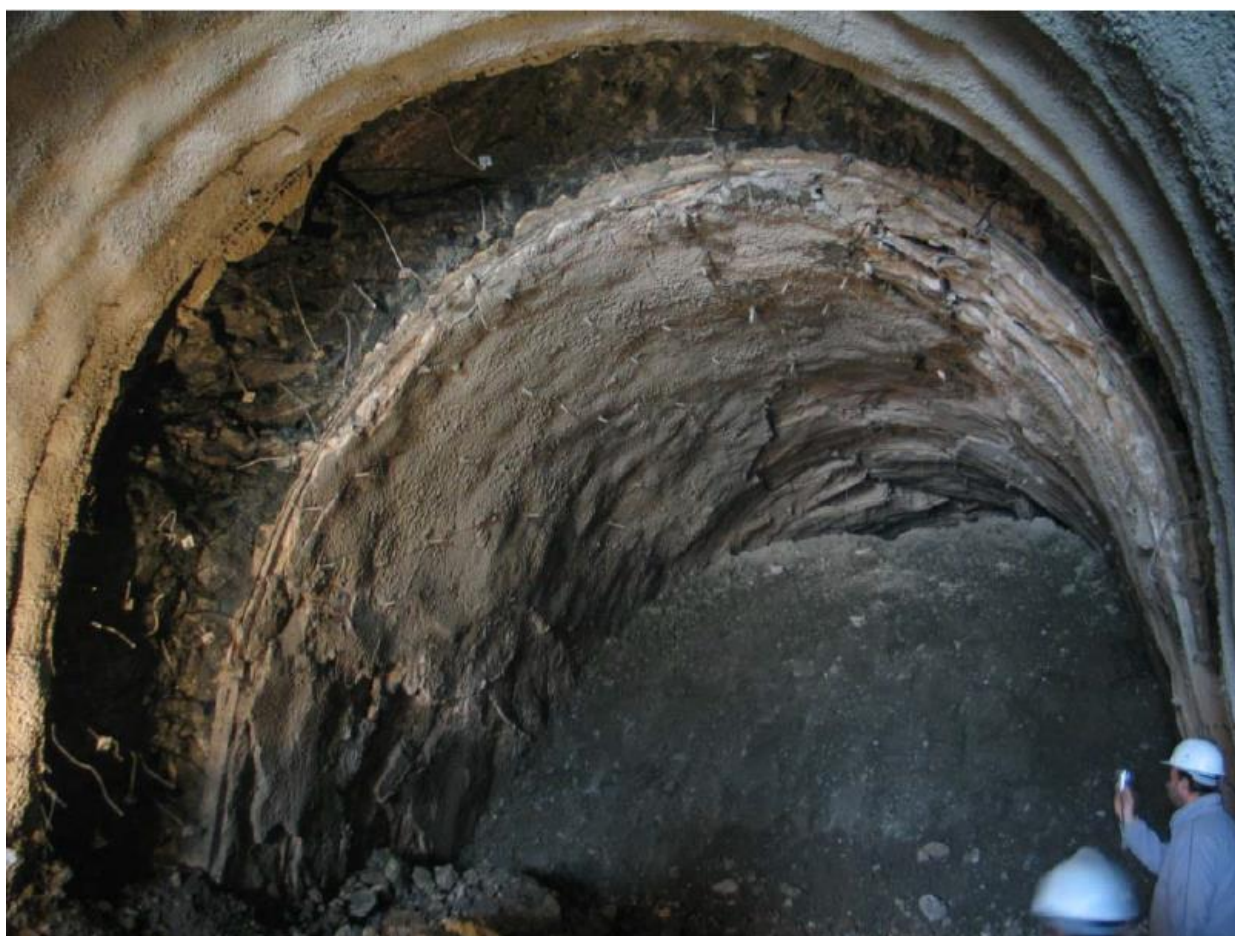
Σχήμα 7: Αυξημένες παραμορφώσεις και ρωγματώσεις προσωρινής υποστήριξης αριστερής παρειάς (ΕΓΝΑΤΙΑ ΟΔΟΣ Α.Ε.)
