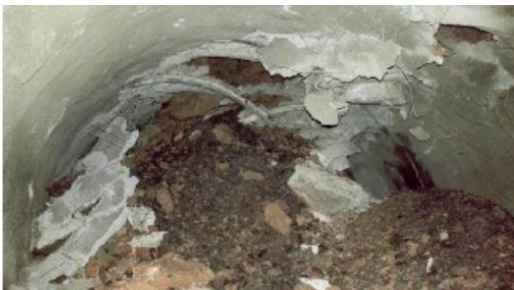
Σχήμα 6: Αστοχία στο θόλο της σήραγγας (Νότιο μέτωπο) σε Αργιλικό σχηματισμό (ΕΡΓΟΣΕ Α.Ε., 2013)
