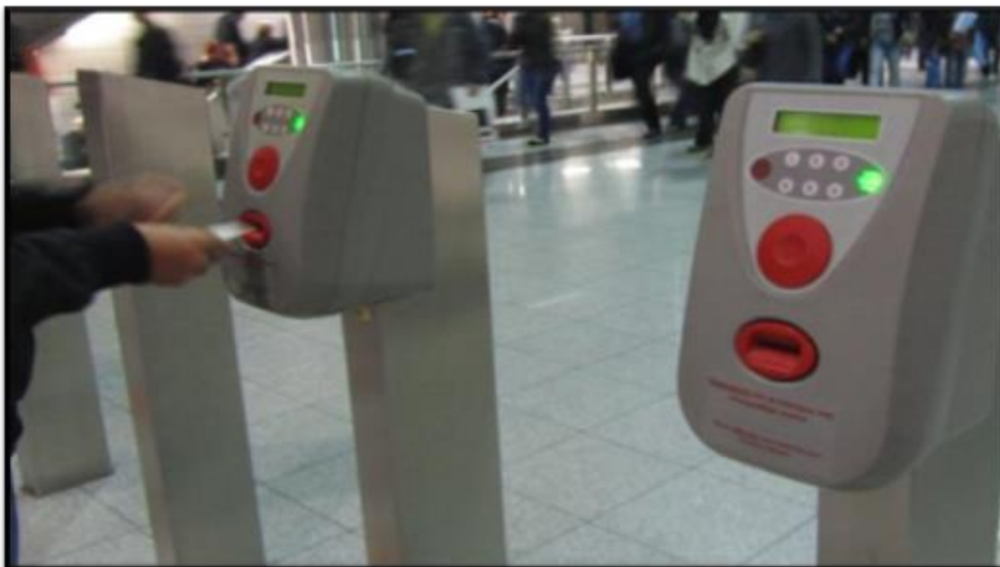
Εικόνα 6.1: Μηχανήματα επικύρωσης εισιτηρίου (προηγούμενη εγκατάσταση) - ΜΕΕ
