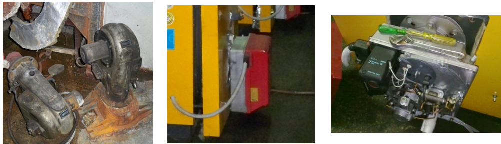
Εικόνα 2.2: Καυστήρες Νοσοκομείου «Παίδων»
