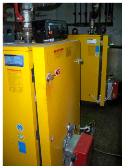
Εικόνα 4.20: Λέβητες / Καυστήρες Νοσοκομείου
