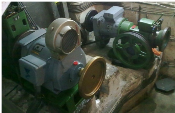
Εικόνα 3.7: Ηλεκτροκινητήρες για τους ανελκυστήρες
