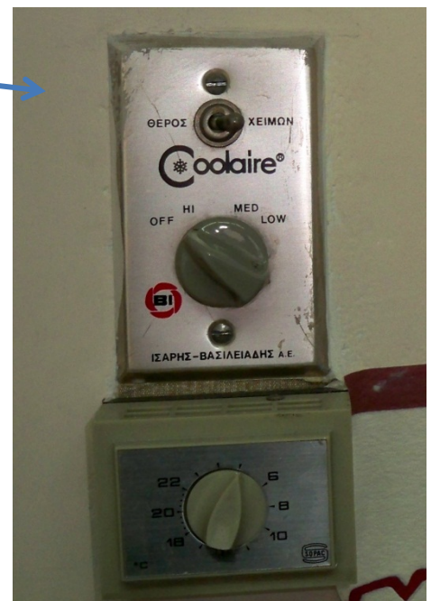
Εικόνα 3.6: Όργανα χειρισμού και αυτοματισμού λειτουργίας
