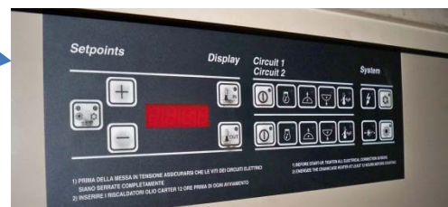
Εικόνα 7.4: Ηλεκτρικός Πίνακας Ψυχοστασίου
