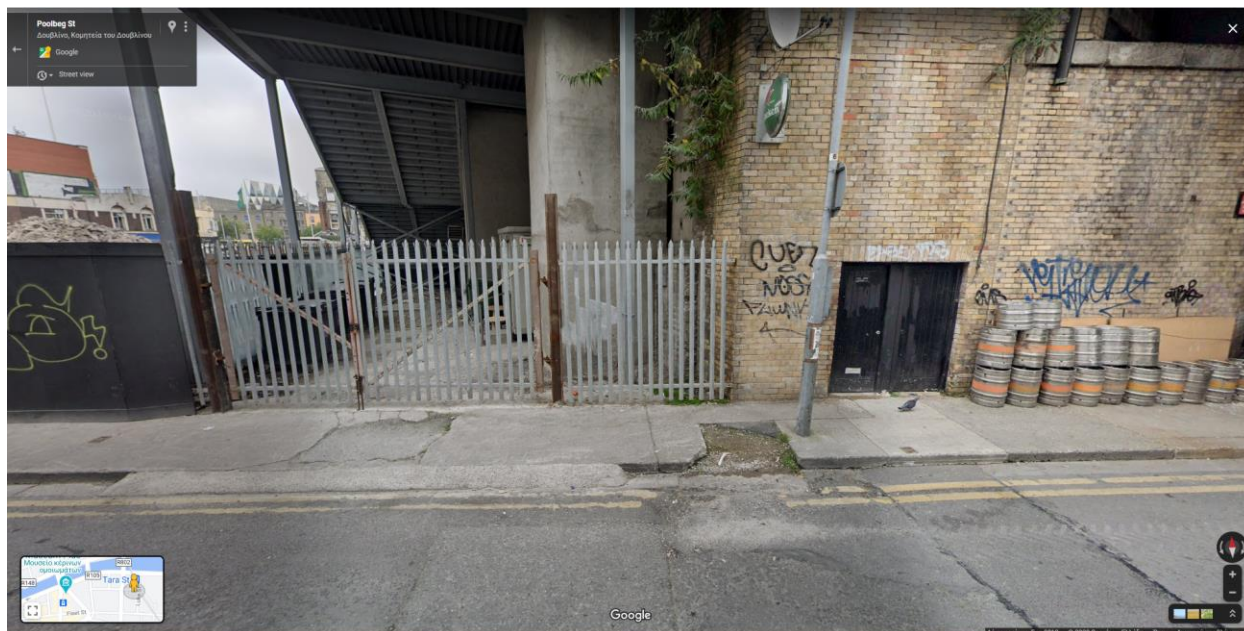
Εικόνα 4.26: Πεζοδρόμιο με φθορές – S10 = 0 (πηγή: Street View)
