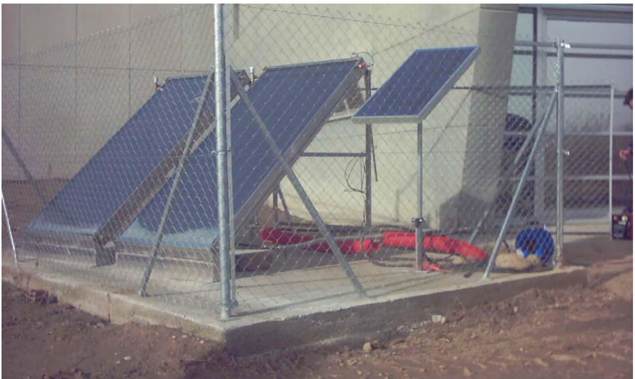
Σχ. 3.29. Ηλιακή εγκατάσταση για μελέτη σε πραγματικές συνθήκες [28]
