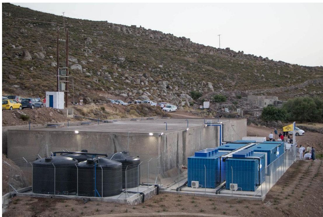
Εικόνα 12 Άποψη του σταθμού αφαλάτωσης της Πάτμου (Πηγή: watera )
