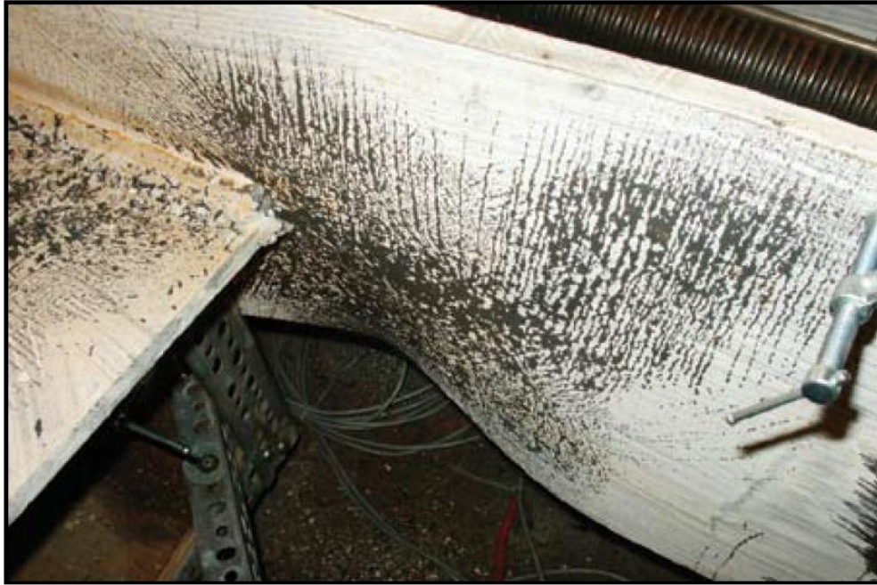
Εικόνα 5.1: Σημαντική διαρροή της δοκού και του υποστυλώματος [18]
