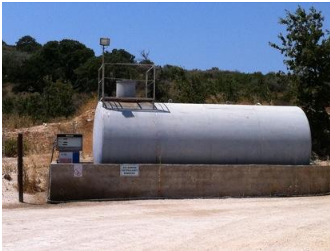
Εικόνα 12: Δεξαμενή Αποθήκευσης Καυσίμων
