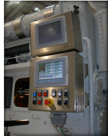
Εικόνα 32 - Local Operating Panel(MAN ES)
