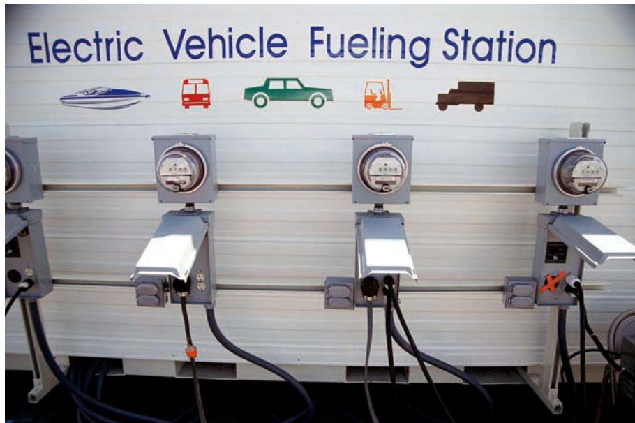
Σχήμα 6.5 Ένας ήδη υπάρχων σταθμός ανεφοδιασμού οχημάτων με ηλεκτρική ενέργεια
