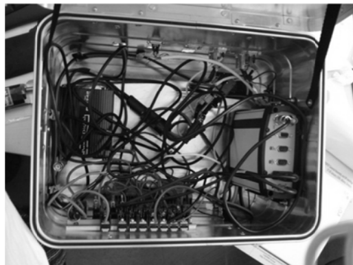
Εικόνα 4-16 Εικόνα από το εσωτερικό της φορητής μονάδας αισθητήρων
