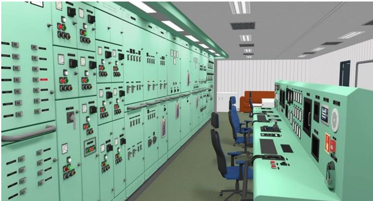
Σχήμα 4.1.1 Engine Control Room (πηγή: https://www.wingd.com )
