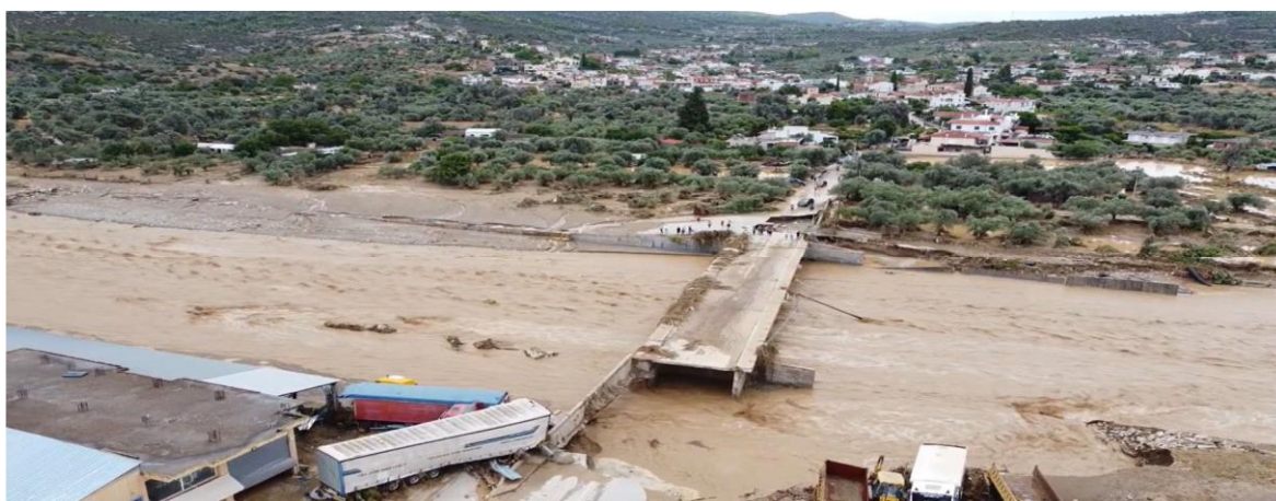
Εικόνα 2.17 Άποψη της γέφυρας του Αφρατίου στην οποία σημειώνεται λόγω διάβρωσης των πρανών γύρω από το ακρόβαθρο (τυπική εικόνα επιπτώσεων σε γέφυρες από την πλημμύρα) (Lekkas E., et al., 2020).
