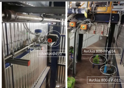
Εικόνα 23. Ροόμετρο, ηλεκτροβάννα και αντλίες δεξαμενής 800-TK-010
