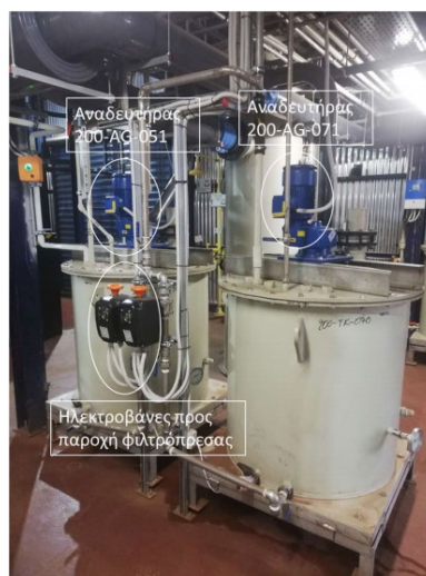
Εικόνα 18. Αναδευτήρες και ηλεκτροβάνες δεξαμενών 200-TK-050 και 200-TK-070
