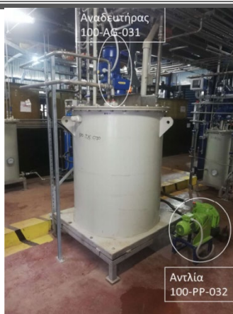
Εικόνα 16. Αναδευτήρας και αντλία δεξαμενής 100-TK-030
