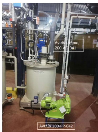
Εικόνα 17. Αναδευτήρας και αντλία 200-TK-040
