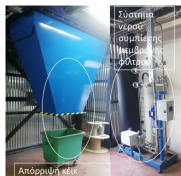
Εικόνα 20. Απόρριψη κέικ και σύστημα νερού συμπίεσης φίλτρων μεμβράνης
