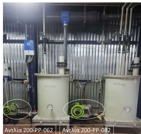
Εικόνα 21. Αντλίες δεξαμενών 200-TK-060 και 200-TK-080
