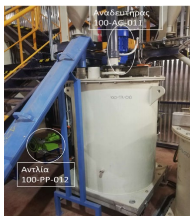
Εικόνα 13. Αναδευτήρας και αντλία δεξαμενής 100-TK-010
