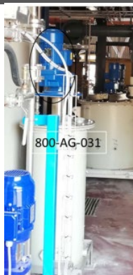
Εικόνα 25. Αναδευτήρας δεξαμενής 800-TK-030
