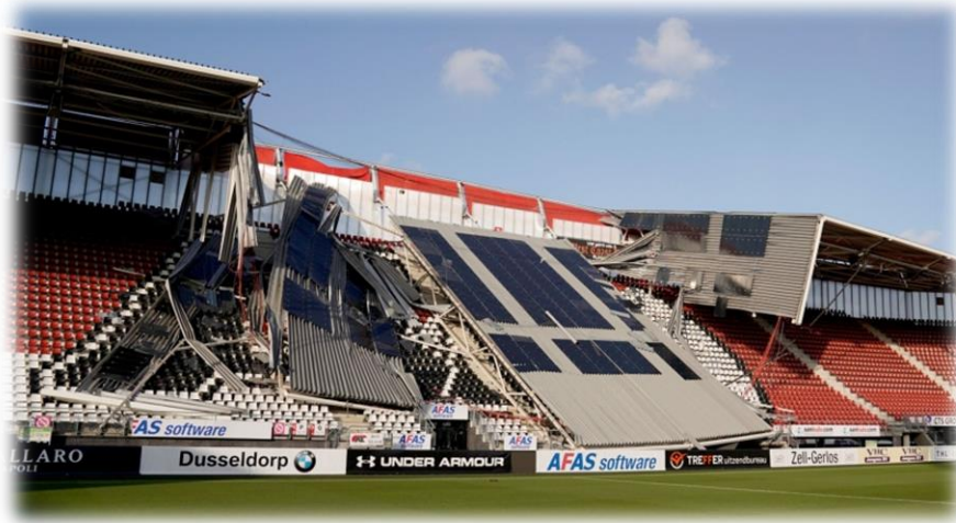
Σχήμα 4.10 : Κατάρρευση Στέγης Γηπέδου της Ομάδας Alkmaar λόγω δυνατών ριπών ανέμου
