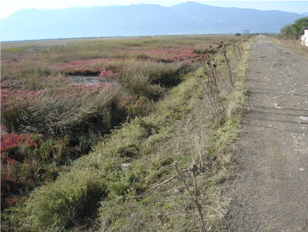
Εικόνα 66: Παράκτιο ανάχωμα – υπερυψωμένος δρόμος ως προστατευτικό μέτρο έναντι της διαβρωτικής δράσης των κυματισμών της θάλασσας.
