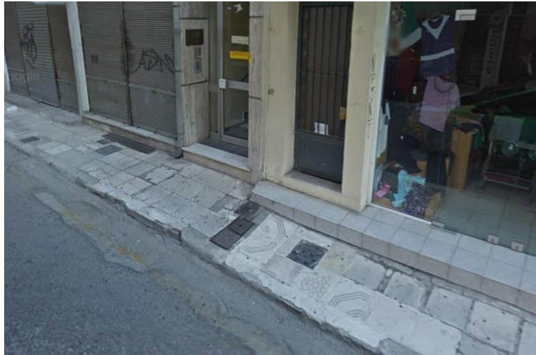
Εικόνα 3.19 Στο υπό εξέταση τμήμα το πεζοδρόμιο έχει εμφανής φθορές S10=0 (Πηγή: Street View)
