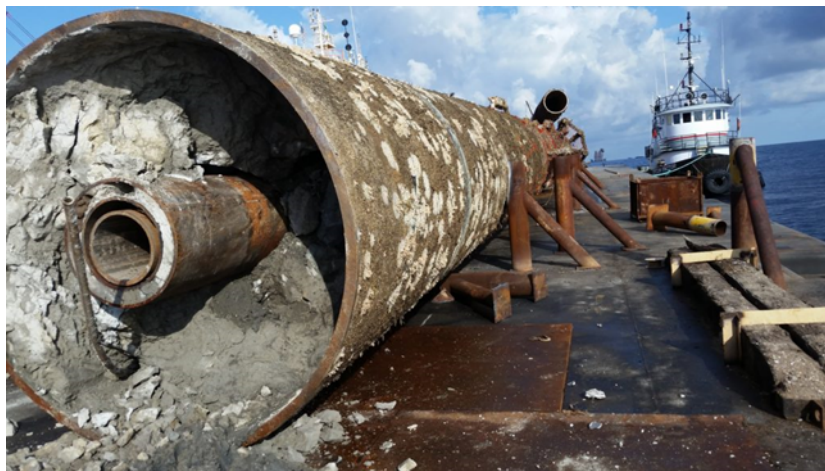
Εικόνα 5-1. Τμήμα της επιφανειακής σωλήνωσης που έχει απομακρυνθεί από την αρχική του θέση και έχει φορτωθεί σε φορηγίδα για να μεταφερθεί για διάθεση στην ξηρά (Mactech Offshore Solutions, 2020)
