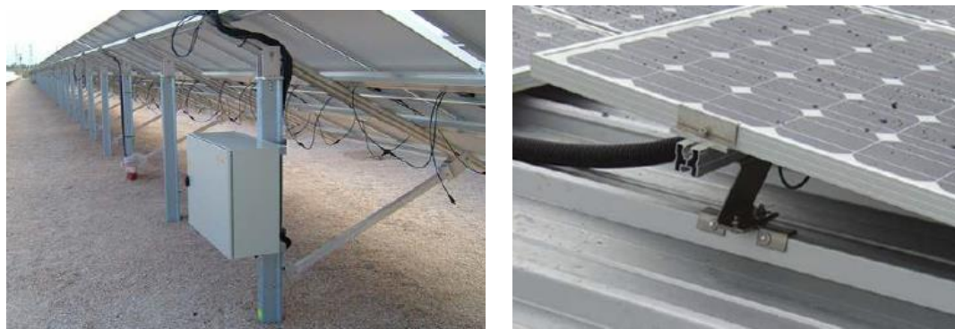
Εικόνα 10: Παράδειγμα εδαφόμπτυξη βάσεων (αριστερά). Σταθερές βάσεις σε οροφή κτιρίου (δεξιά)
