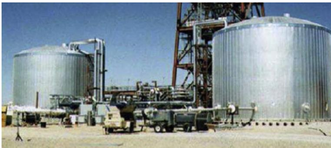
Σχήμα 3.7: Πραγματική εικόνα της εγκατάστασης Solar Two, αριστερά είναι το δοχείο χαμηλής και δεξιά το υψηλής θερμοκρασίας [3.8]
