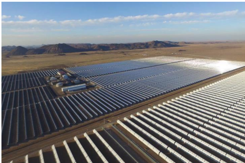
Σχήμα 2.12: Εγκατάσταση ηλεκτροπαραγωγής 100MW με παραβολικούς συλλέκτες (Χίνα, Kaxu solar one) [2.15]
