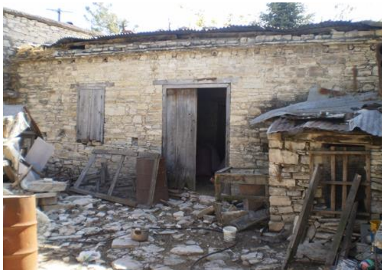
Εικ. 2.111. Παραδοσιακό μακρυνάρι με προσκτίσματα και λιθόστρωτη αυλή σε αγροτικό οικισμό της Πάφου, 2008 (συλλογή συγγραφέα).
